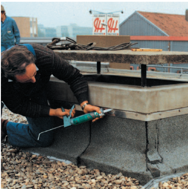
Elastisk tätning av anslutningsfogar på skorsten, mellan betong och intäckningsplåt av rostfritt stål.
